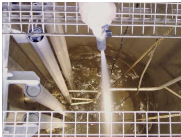
Renspolning i pumpstation
